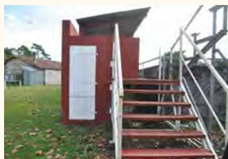
Un escalier à mettre aux normes
