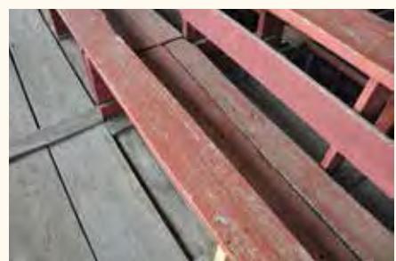
Attention aux risques de chute : vide sous gradins et lame de bois en ressaut
